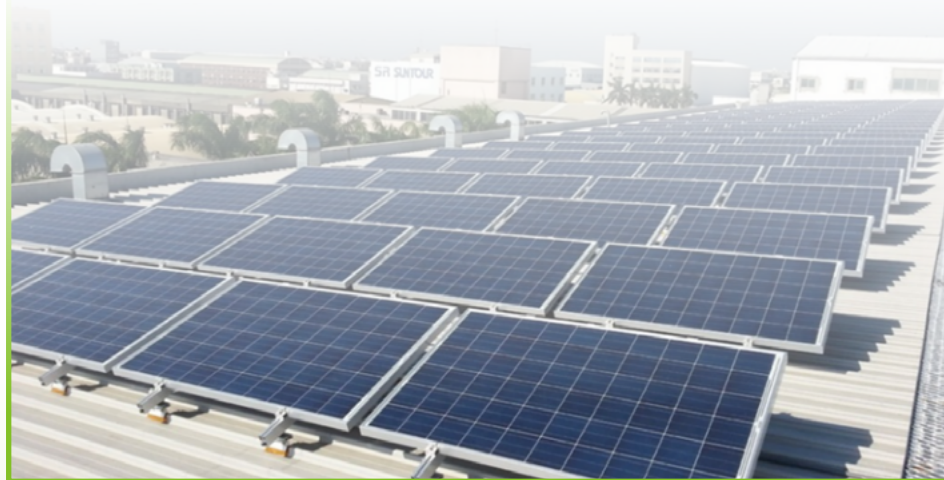
▲ 2015 年建置福興廠頂樓建置太陽能板
