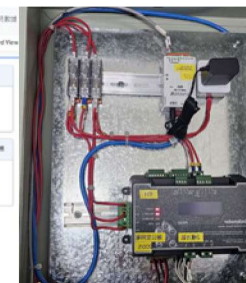
▲ 彰化福興廠 - 數位電錶即時監控
